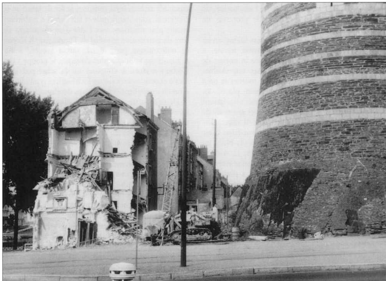
Démolition d'immeubles quai de Ligny (juin 1970) : ils cachaien le château. - © Collection Robert Brisset, archives municipales / Photothèque d'Angers -
